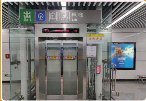
福田地铁站无障碍电梯
